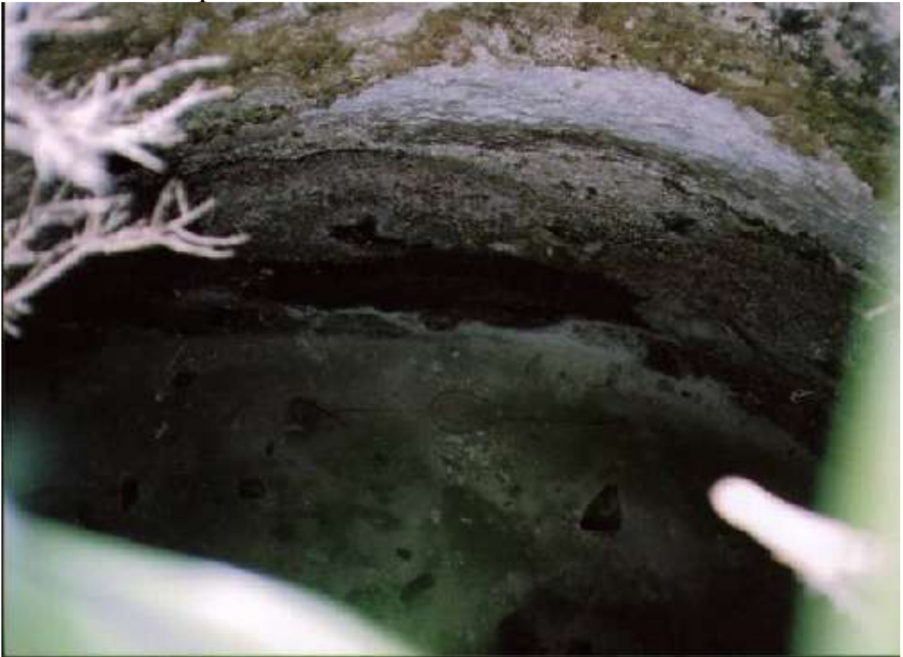
Monte San Giuliano Silos 4 - diametro 3m.
